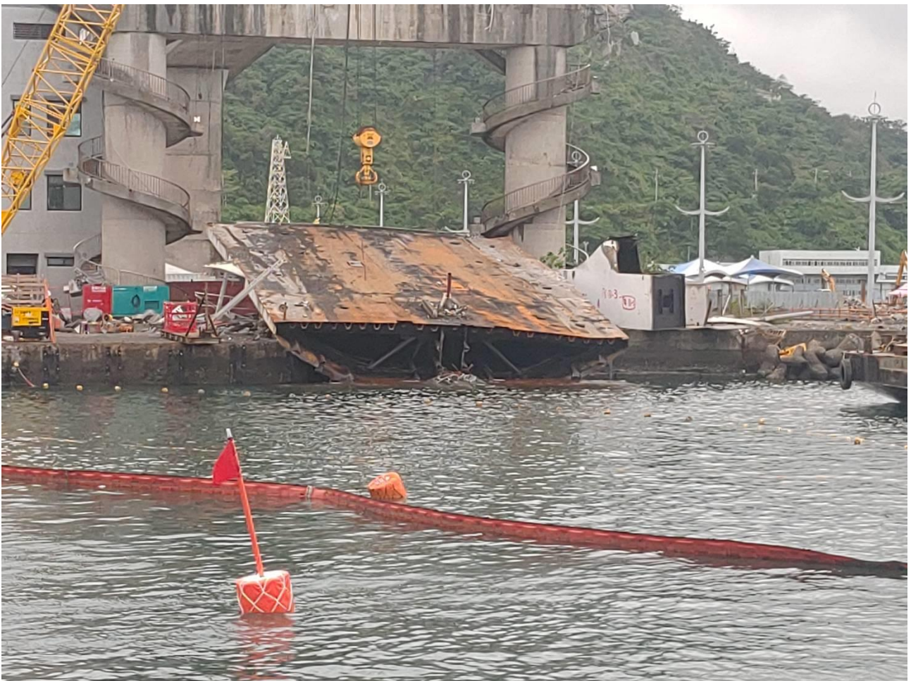
圖 1：南方澳跨港大橋拆除，最困難之移山路側海陸面交界橋面版切割完成
