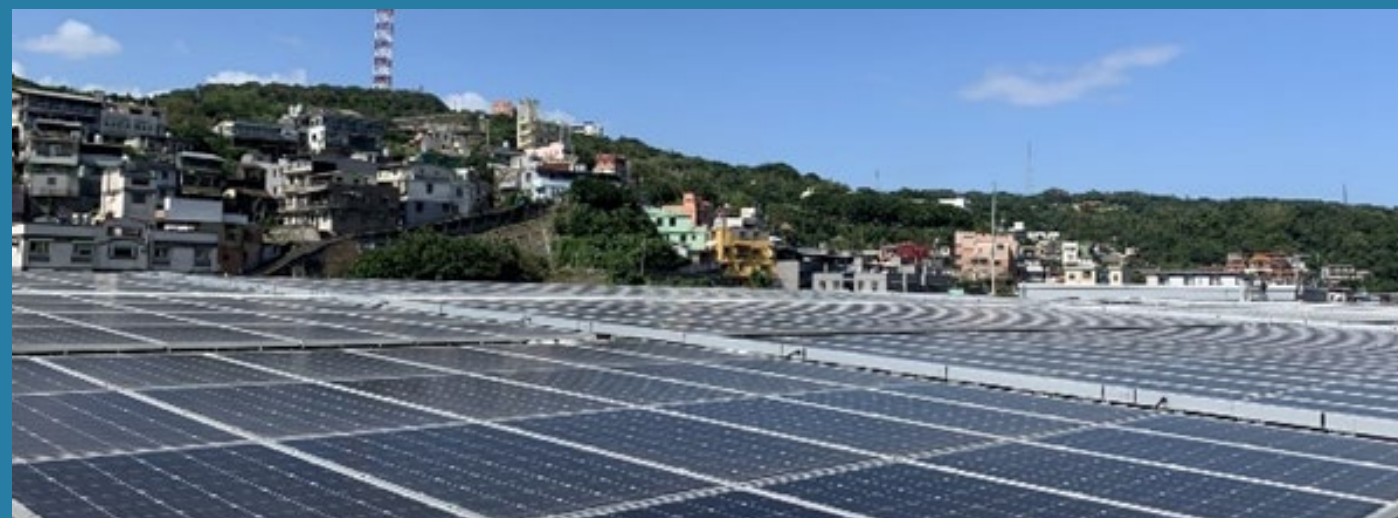
西七倉庫頂樓太陽能板
