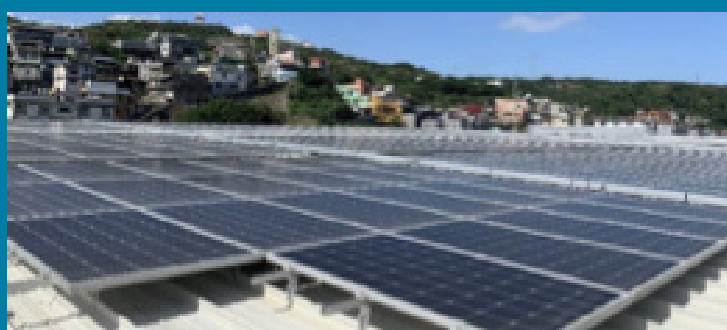
西 7 倉庫頂樓太陽能板
